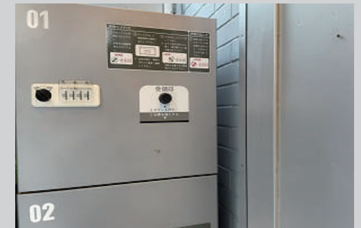
宅配ボックス
